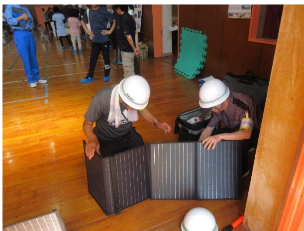
太陽光発電を使った非常電源設置
