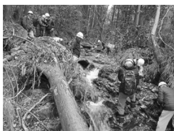
被害状況を確認中
